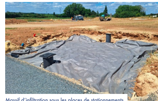
Massif d'infiltration sous les places de stationnements
