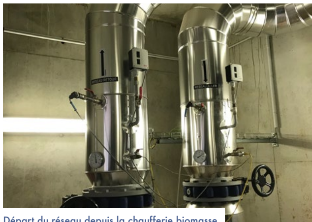
Départ du réseau depuis la chaufferie biomasse
