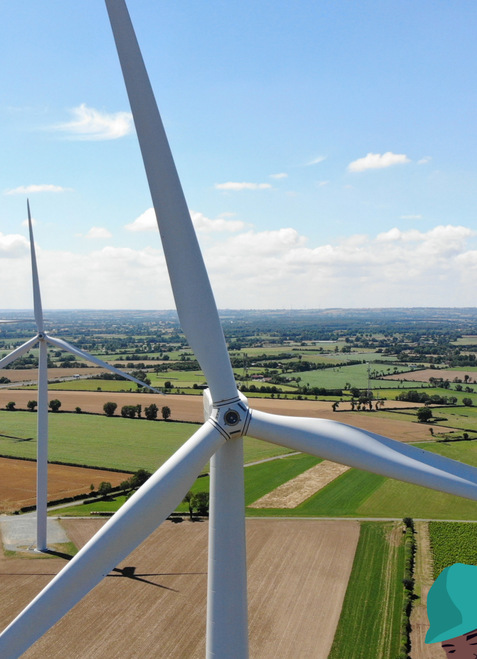
Parc éolien de l'Hyrôme Chemillé-en-Anjou
